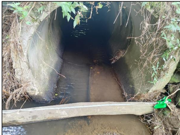
Figura 188. Seção instalada para medição de vazão.
