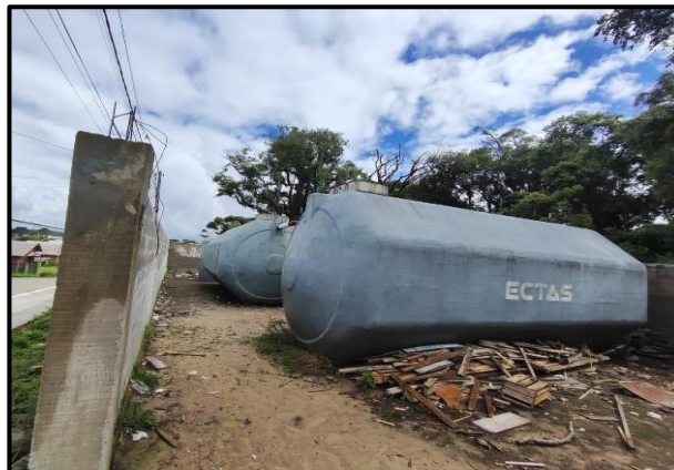
Figura 74. Reatores biológicos na ETE Santa Marta.
