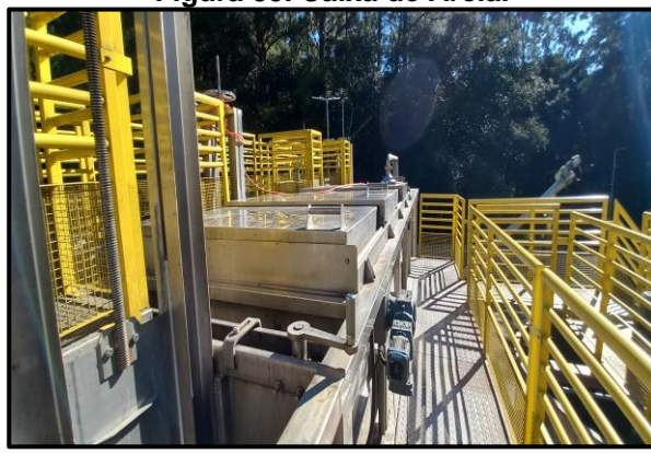
Figura 85. Caixa de Areia.
