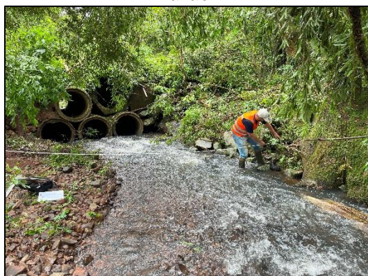
Figura 182. Seção instalada para medição de vazão.
