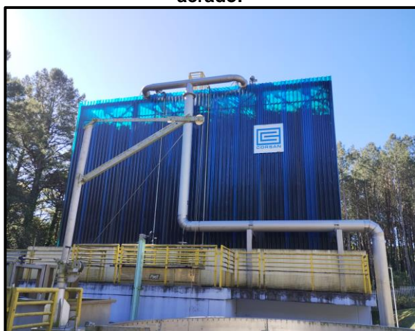
Figura 94. Filtro Biológico – Percolador aerado.
