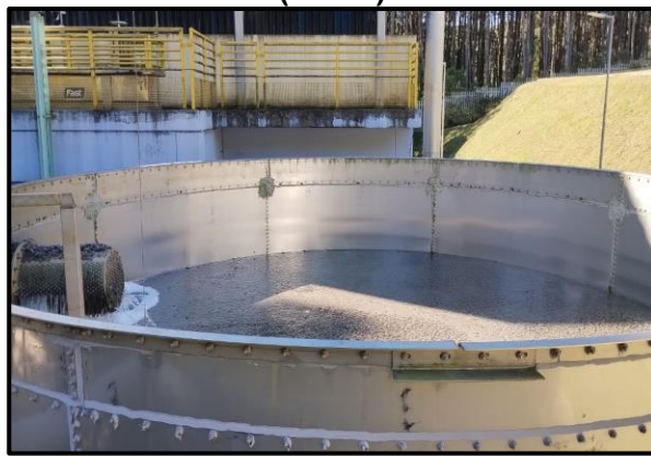
Figura 93. Reator biológico de leito móvel (MBBR)
