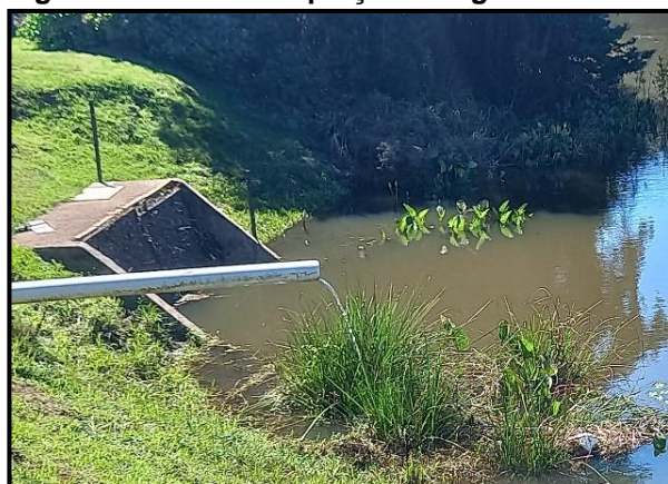
Figura 1. Ponto de captação de água brut
