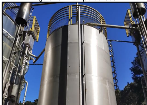
Figura 101. Tanque de lodo.
