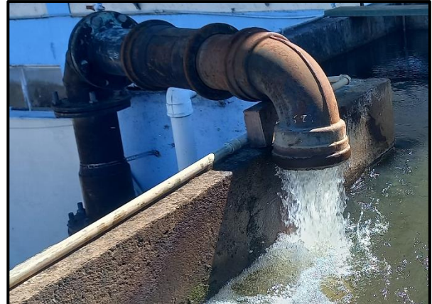
Figura 22. Entrada da água de reuso.
