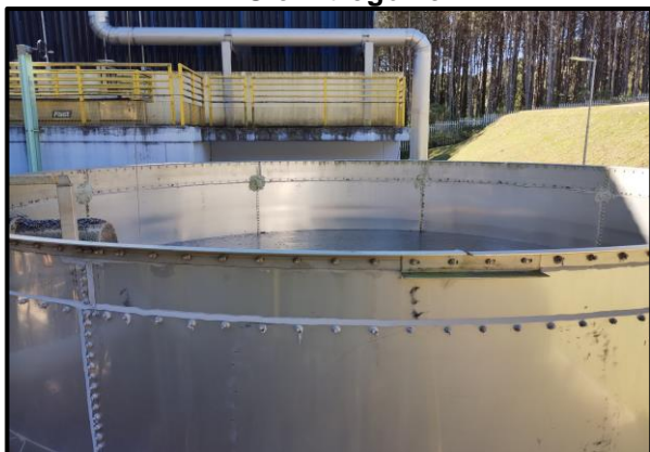
Figura 92. Tanque anóxico - Removedor de DBO e Nitrogênio.
