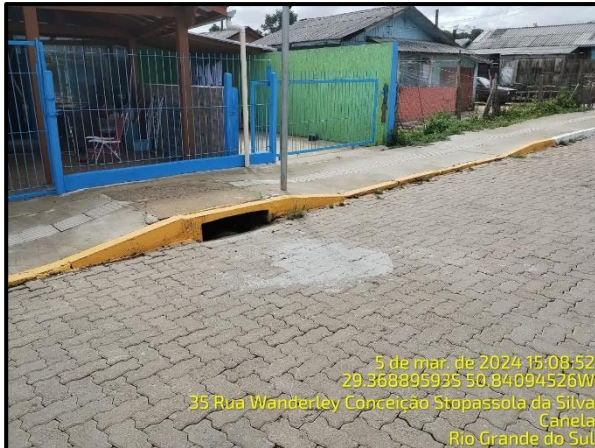
Figura 5. Boca de Lobo.
