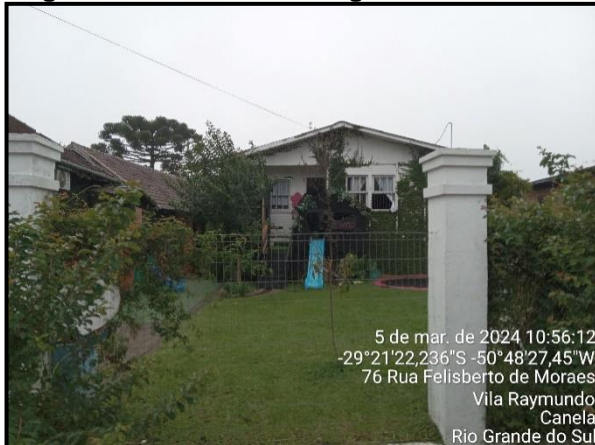
Figura 14. Escolinha com problemas de alagamento devido a drenagem.
