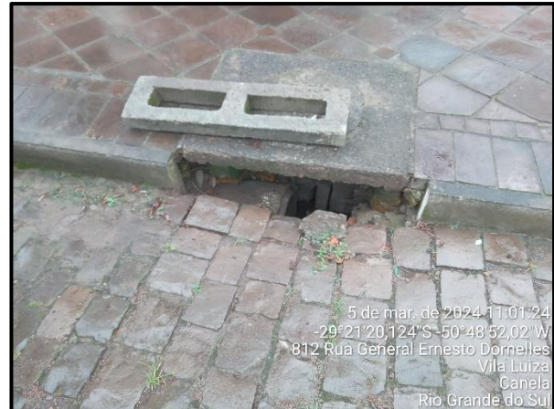
Figura 6. Boca de Lobo com problemas de dimensionamento.
