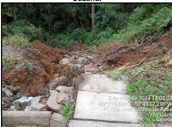
Figura 16. Problema de drenagem - Vila Suzana.
