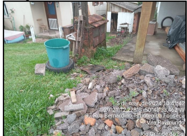
Figura 15. Caso com problema devido a drenagem.
