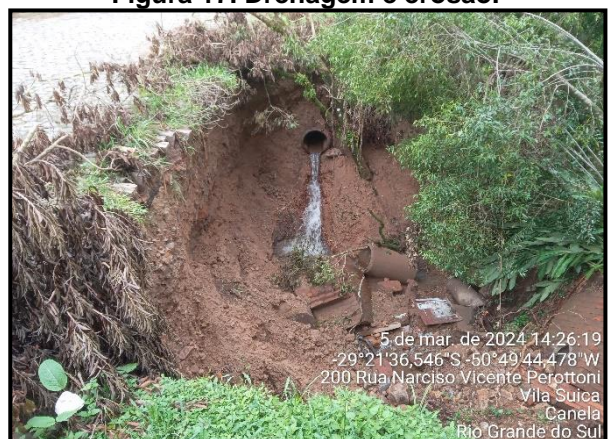
Figura 17. Drenagem e erosão.
