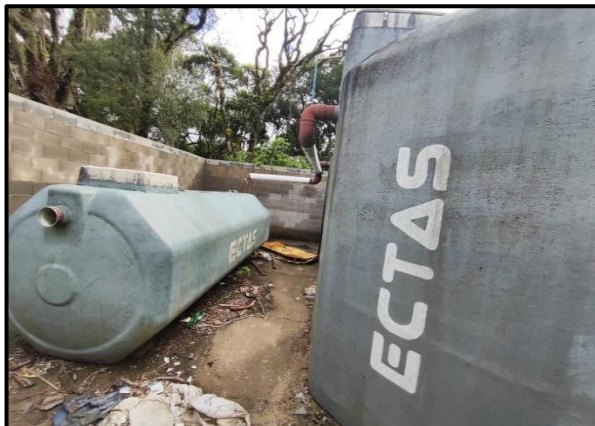
Figura 73. Saída decantador para desinfecção na ETE Santa Marta.
