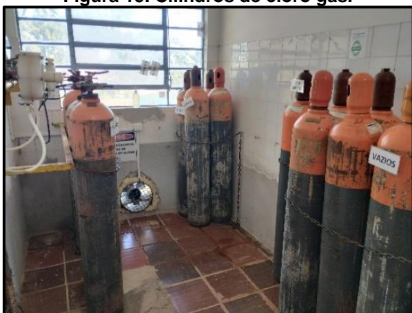
Figura 15. Cilindros de cloro gás.
