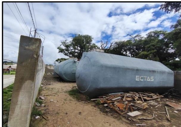
Figura 74. Reatores biológicos na ETE Santa Marta.
